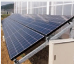
屋外独立型太陽光発電システム(蓄電) 2.28kW(190W×12枚)
